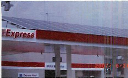
太陽光発電施設
