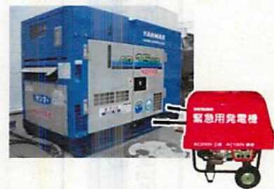
内燃機関発電施設
